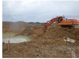
Profilage en cours d'une fosse d'excavation en eau pour éviter une zone piège
