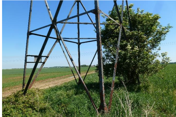
Photo 19. Pylône électrique et friche herbacée
