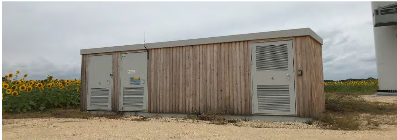
Illustration 79 : Exemple de poste de livraison avec bardage vertical de bois naturel (source : JPEE)
